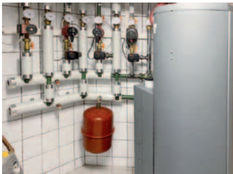
Sanierung & moderne Heizungslösungen
